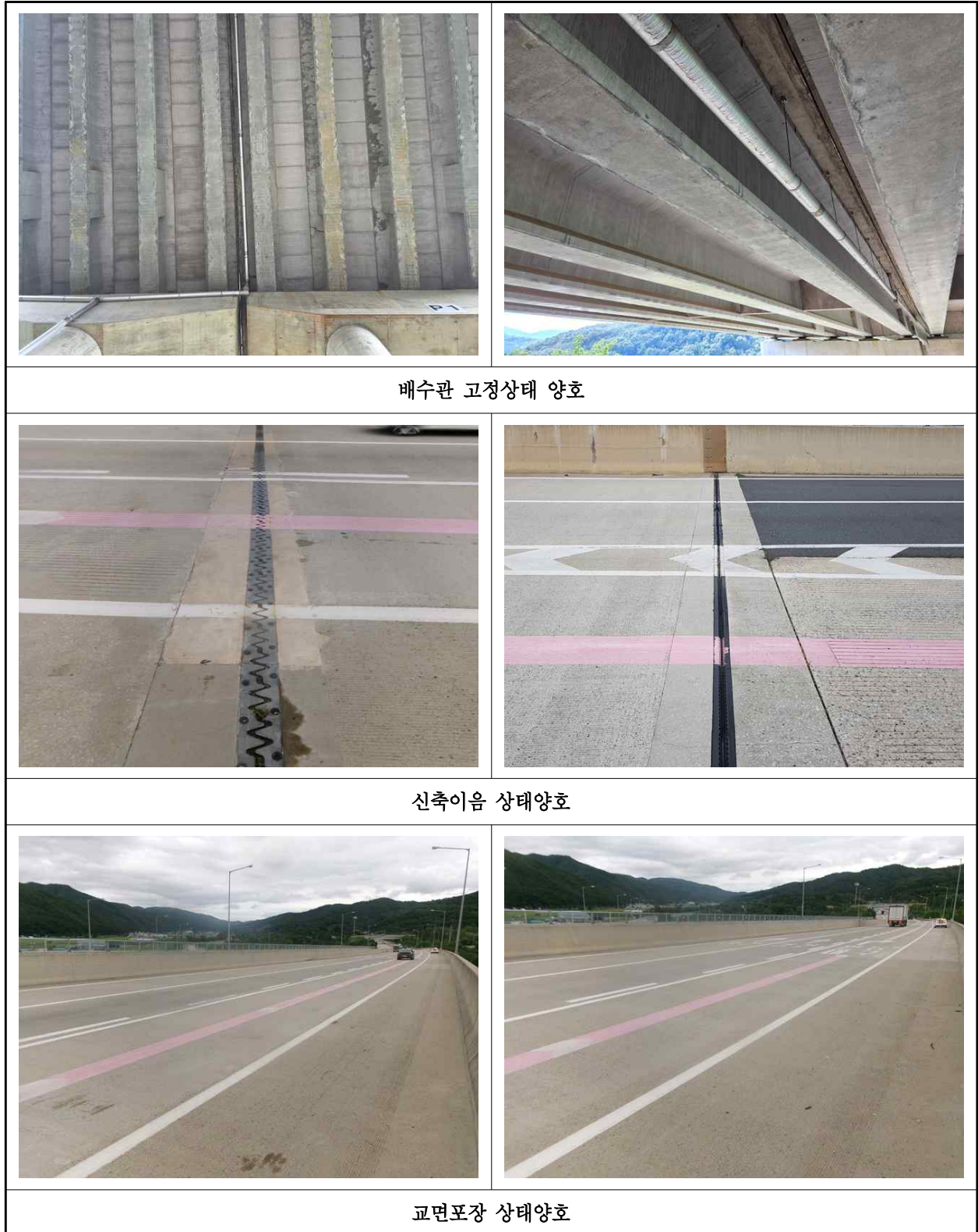
【사진 14.3.51】 교량의 공중이용시설 10대 위험요소 손상현황(계속)
